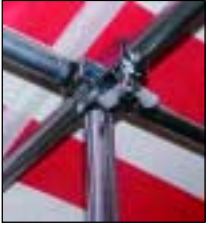
Spezial-Aufnahme der Stütz- und Spannstange
